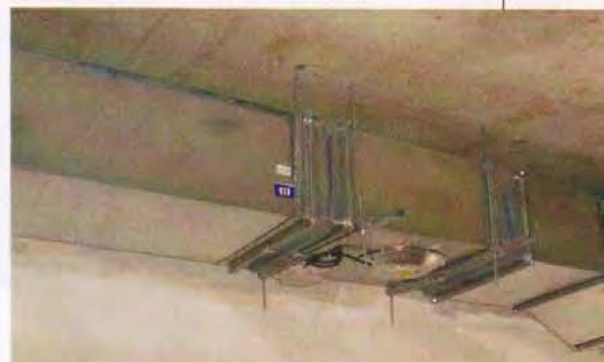
Часть смонтированной системы наборной принудительной вентиляции
